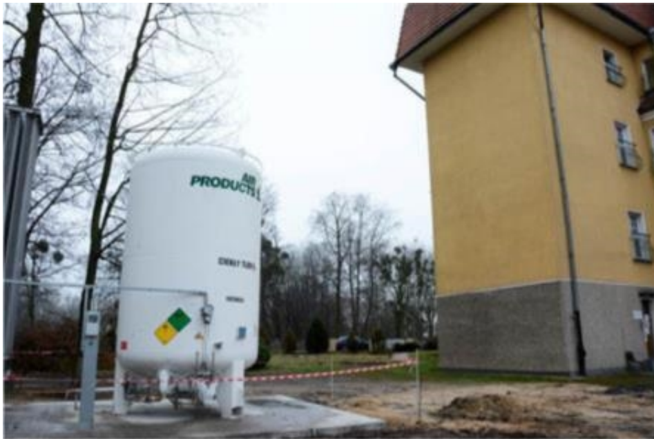
Instalacja tlenowa w Powiatowym Centrum Zdrowia S.A. w Kluczborku
